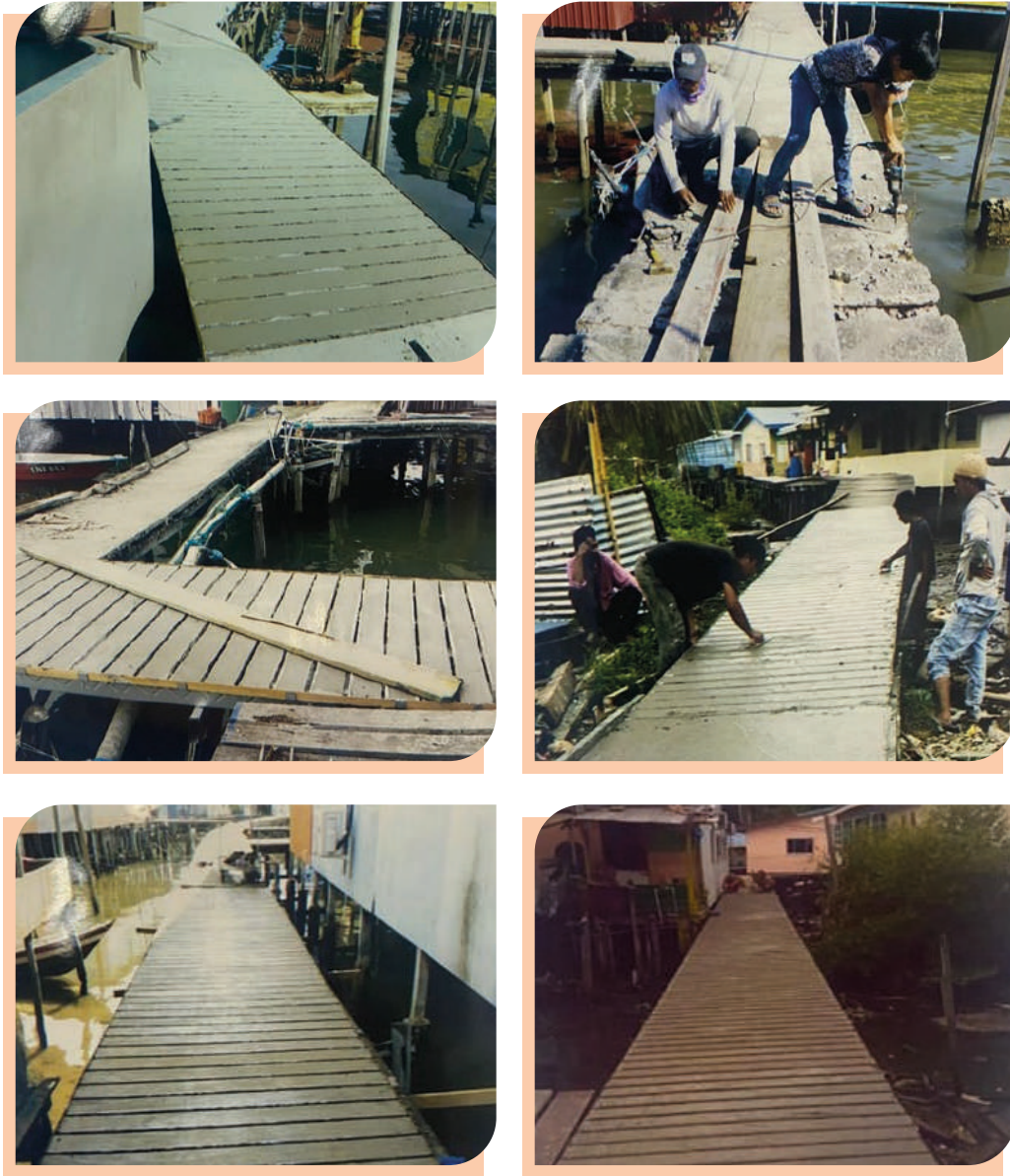
Gambar 37: Penyelenggaraan Titian Pejalan Kaki.
